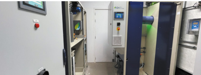
In gebruik name zoutelektrolyse in de binnen- en buitenbaden
